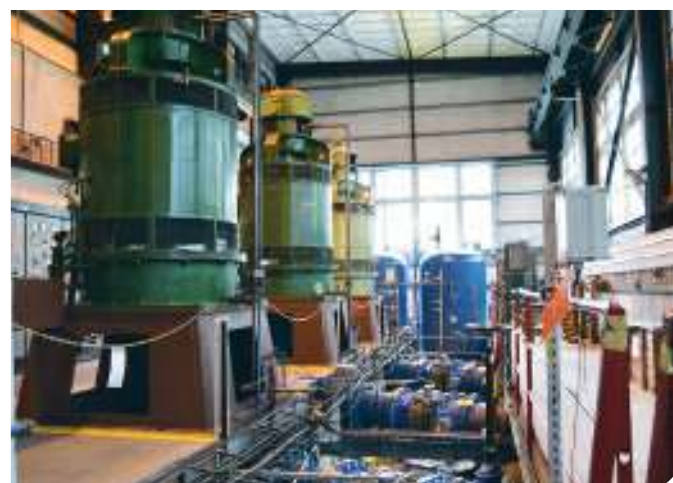
Vodu pohánějí tři čerpadla, každé o výkonu tisíc litrů za vteřinu
